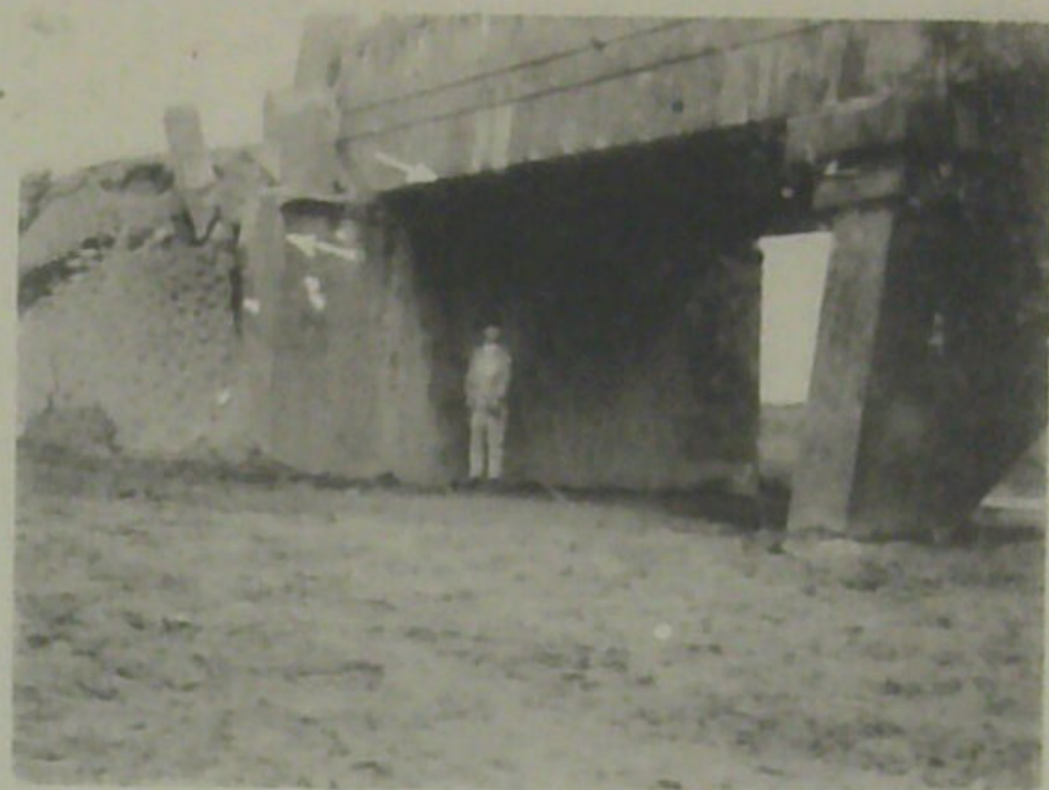
(8)、大目降橋之毀壞，北端橋身較橋脚向東走出 46 公分 (35、12、27 攝)
