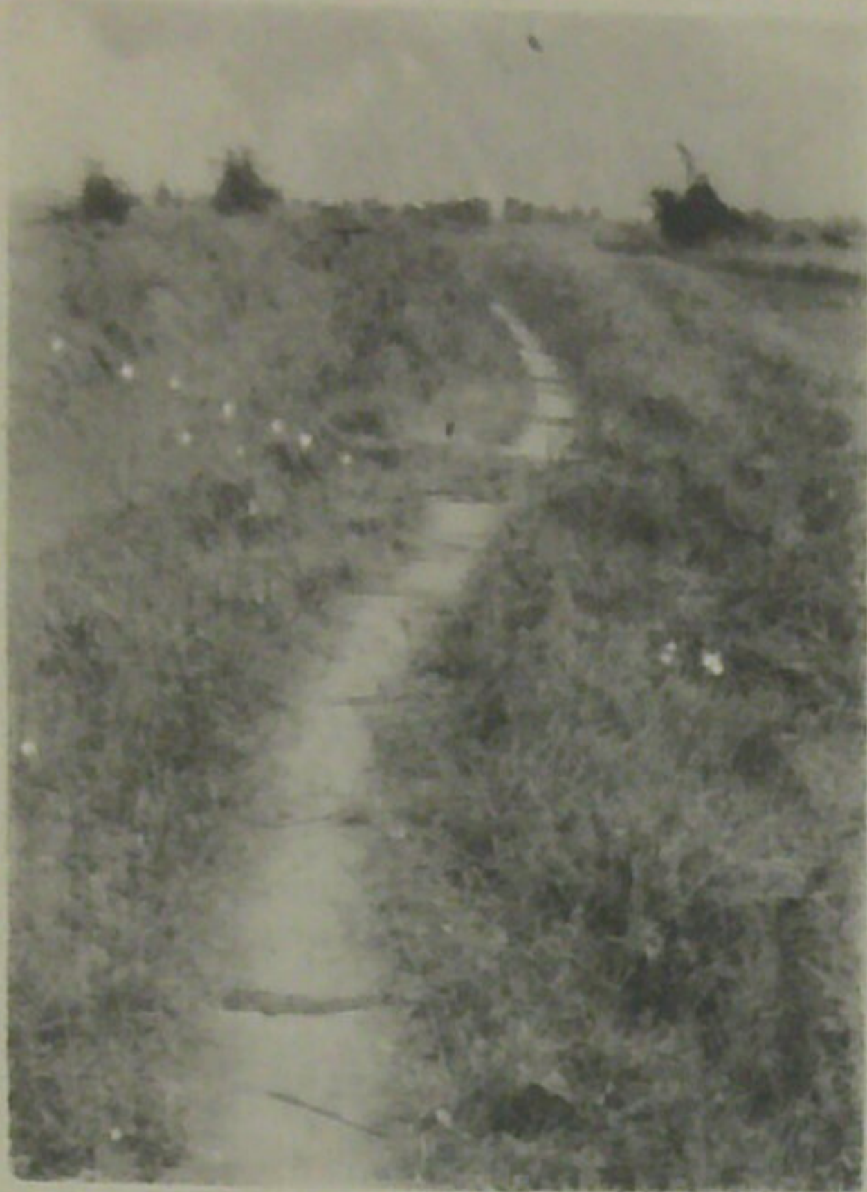
(7)、思橋西約 350 公尺嘉南大圳堤岸之雁行裂痕及中段凹字形陷落 (35、12、28 攝)
